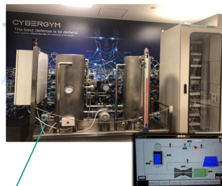
赤坂 OT(制御向け)トレーニング設備
